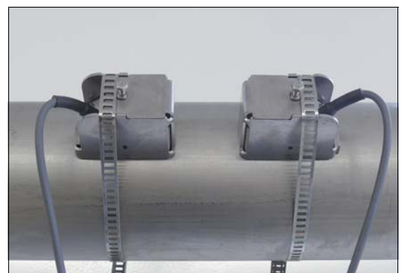
Transductores de caudal en el dispositivo de captación, fijados con abrazaderas de tensión
