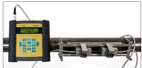
Mesure avec transmetteur de débit fixé par le kit de fixation sur la conduite
